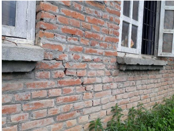
(d) Diagonal Cracks originating from opening
