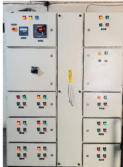
F. Capacitor Bank
