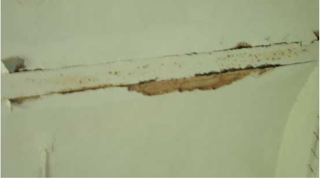
(चित्र नं. २० ग्यालरी 'एफ' मा रहेको सिलिङ्को अवस्था)
