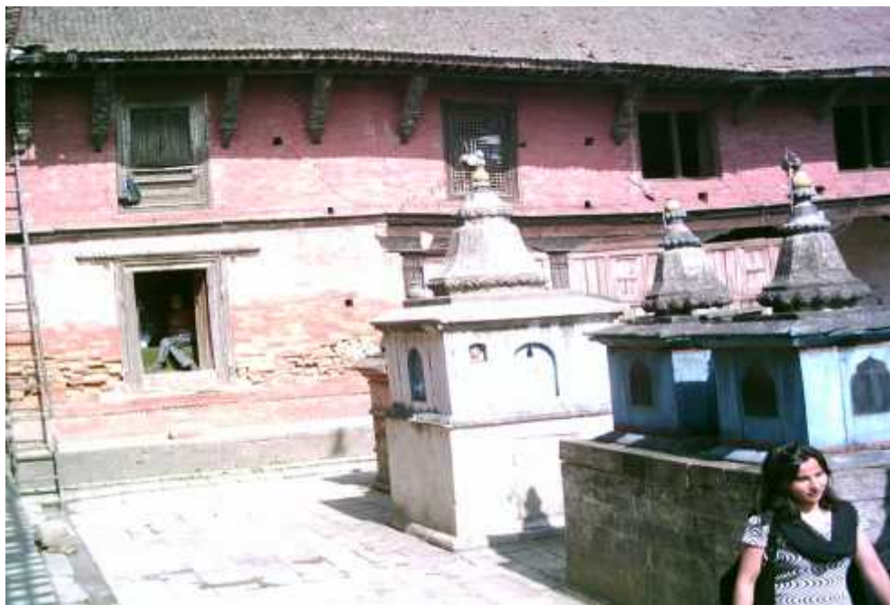
मुख्य मन्दिर प्राङ्गणको जीर्ण अवस्थाम्बा रहेको सत्तल
