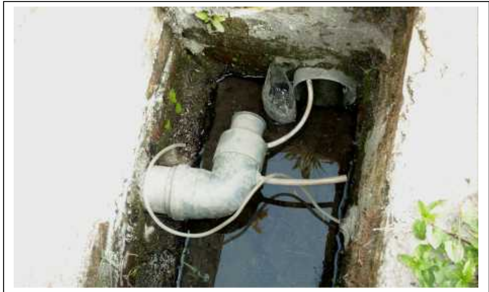
Outlet of VF bed
